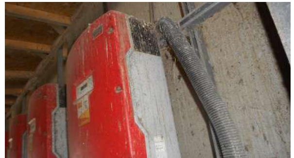
Omvormers in kippenstal. Foto: SOBH.
