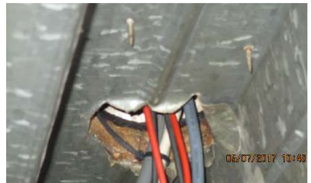
(Onder andere) niet brandwerend afgewerkte doorvoeringen van PV-bekabeling door een brandscheiding heen. Foto: Univé
