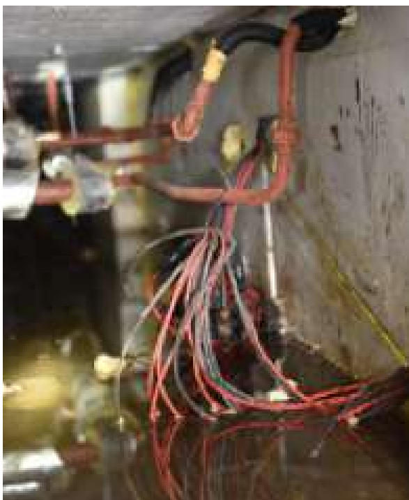
Voorbeeld PV-bekabeling in kruipruimte. Roest in connectoren heeft geleid tot een vlamboog. Foto: Brandweer Nederland.
