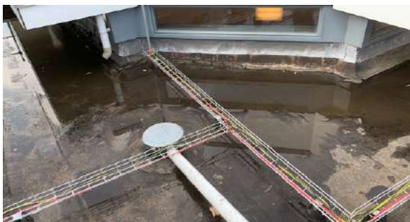
Verhoogde kabelgoten op het dak. Foto: SOBH
